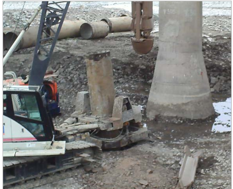
Figura 3 – Realización de excavaciones. Se observa la LINK BELT realizando sujeción de la camisa y manejo de la cuchara simultáneo.
