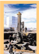
Perforación en roca con Mustang A66CBDT. Obsérvese el puente metálico diseñado especialmente para montar la máquina sobre las estaciones de hormigón armado de los telescopios.
