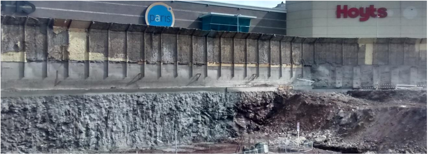
Foto 4 - SECTOR B – EDIFICIO MAIPU- Socialzado y doble línea de columnas de Jet Grouting como barrera de baja permeabilidad no estructural. (ver Fig-2)
