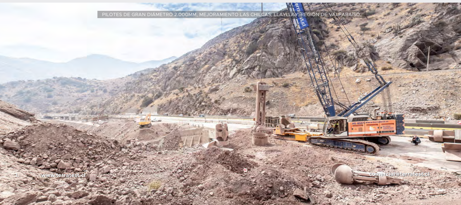
PILOTES DE GRAN DIÁMETRO 1.800MM, PUENTE TRENG TRENG Y KAY KAY, PADRE LAS CASAS, TEMUCO.
