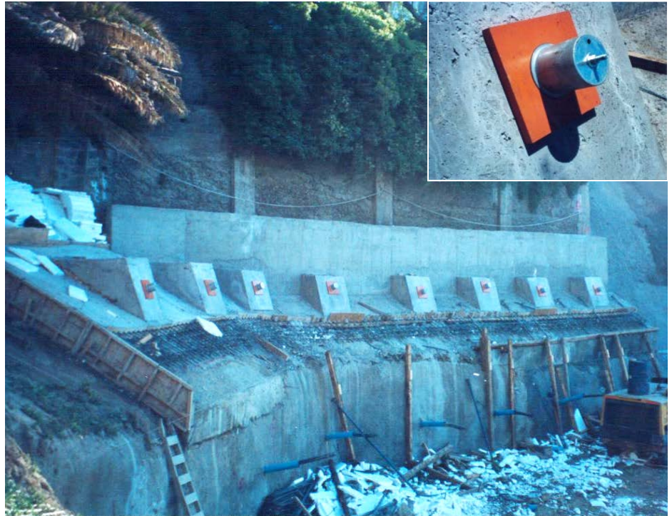
Foto 1 – Detalle de Apoyos y Cabeza Anclaje Permanente
