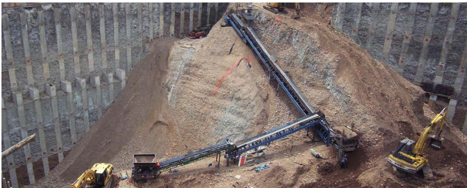
Foto 3 y 4 – Vista de las pila durante la excavación y retiro de material
