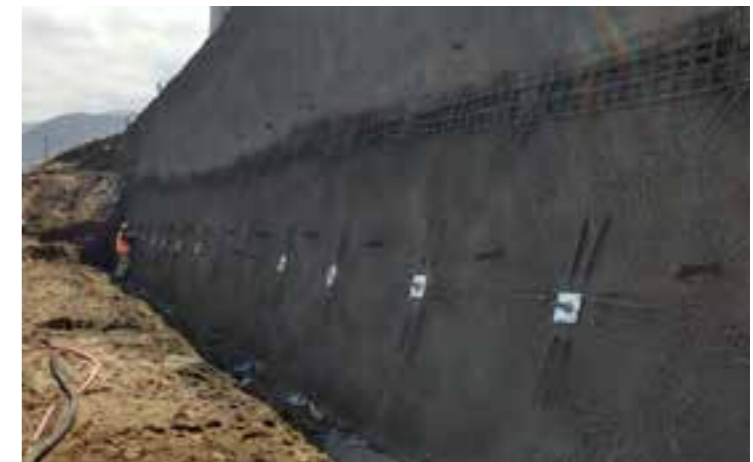
Placas de anclajes.
