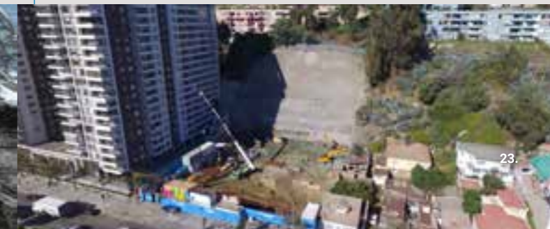
Sostenimiento de Talud con Soil Nailing Edificio Álvarez, Viña del Mar Chile
