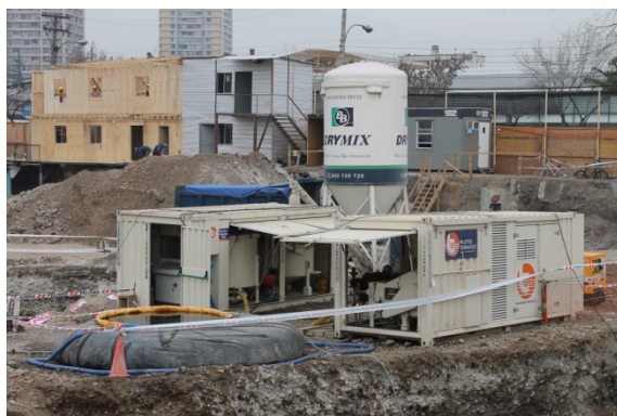
Planta de JG: Silo – Planta de Mezcla - Bombeo
