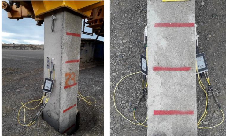
Fig. 6 – Vista en plata Nave de Industrial, Pilotes instrumentados con PDA en etapa de mapeo
